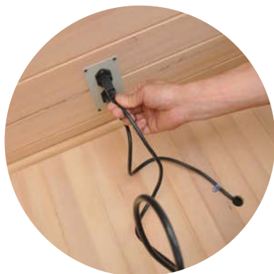
Zapojené kabely topidel
